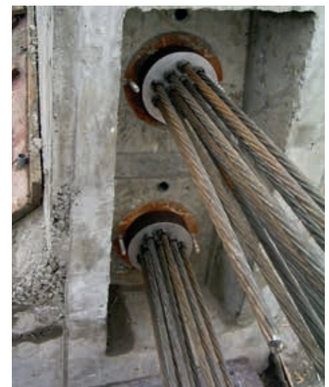
Ryc. 2. Kable sprężające złożone ze splotów, fot. B. Karaś
