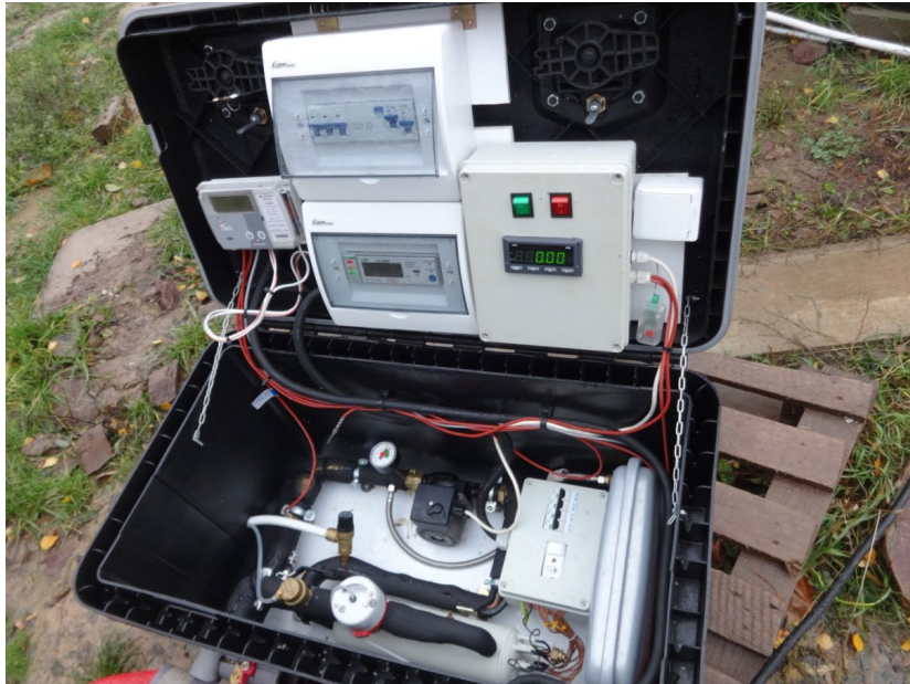
Rys. 3. Wykonane urządzenie do TRT
