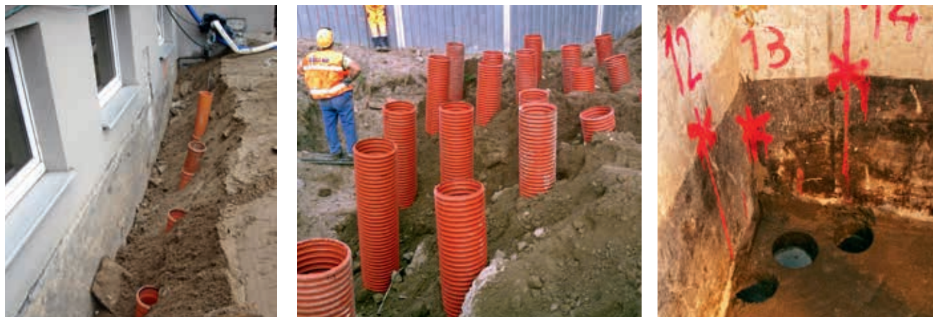
Ryc. 14–16. Prace zabezpieczające instalacje: (po lewej) wzdłuż ściany, (w środku) na placu budowy, (po prawej) przewiertu rdzeniowe fundamentów
