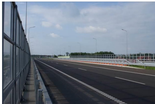
Fot. 2. Ekrany akustyczne. Obwodnica Radomia. Węzeł Wolanów [fot. T. Perzyński]
