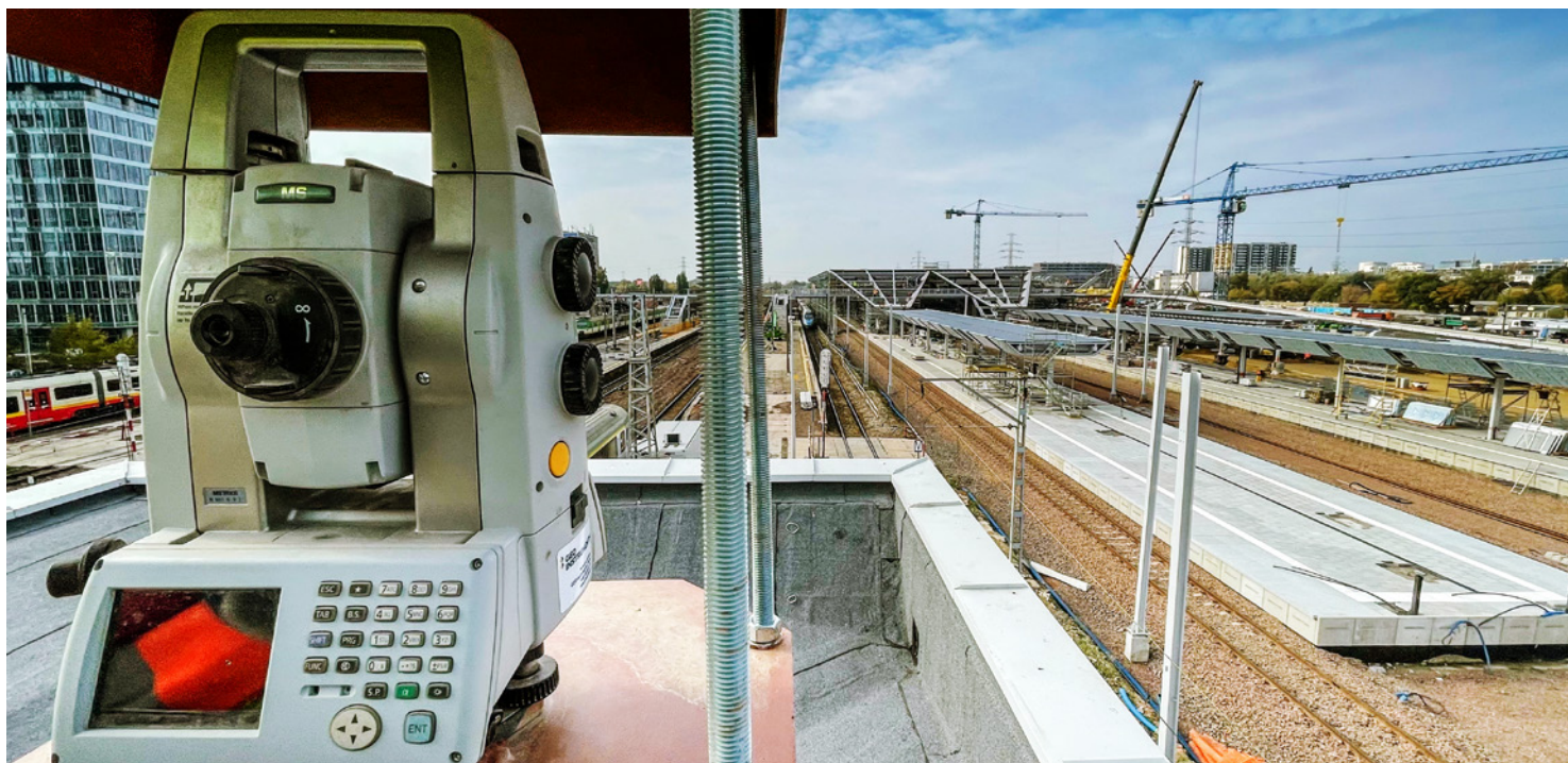
Podczas przebudowy stacji kolejowej Warszawa Zachodnia, w trakcie prowadzenia robót związanych z wykonywaniem tunelu metodą podstropową, zastosowano geodezyjny automatyczny monitoring infrastruktury kolejowej. Z uwagi na konieczność utrzymania ruchu pasażerskiego wykonanie całej instalacji systemu odbyło się na czynnym torowisku z uwzględnieniem najwyższych standardów bhp i pod okiem sygnalistów. Całym procesem pomiarowym zarządzało specjalistyczne oprogramowanie, fot. GEO-Instruments Polska
