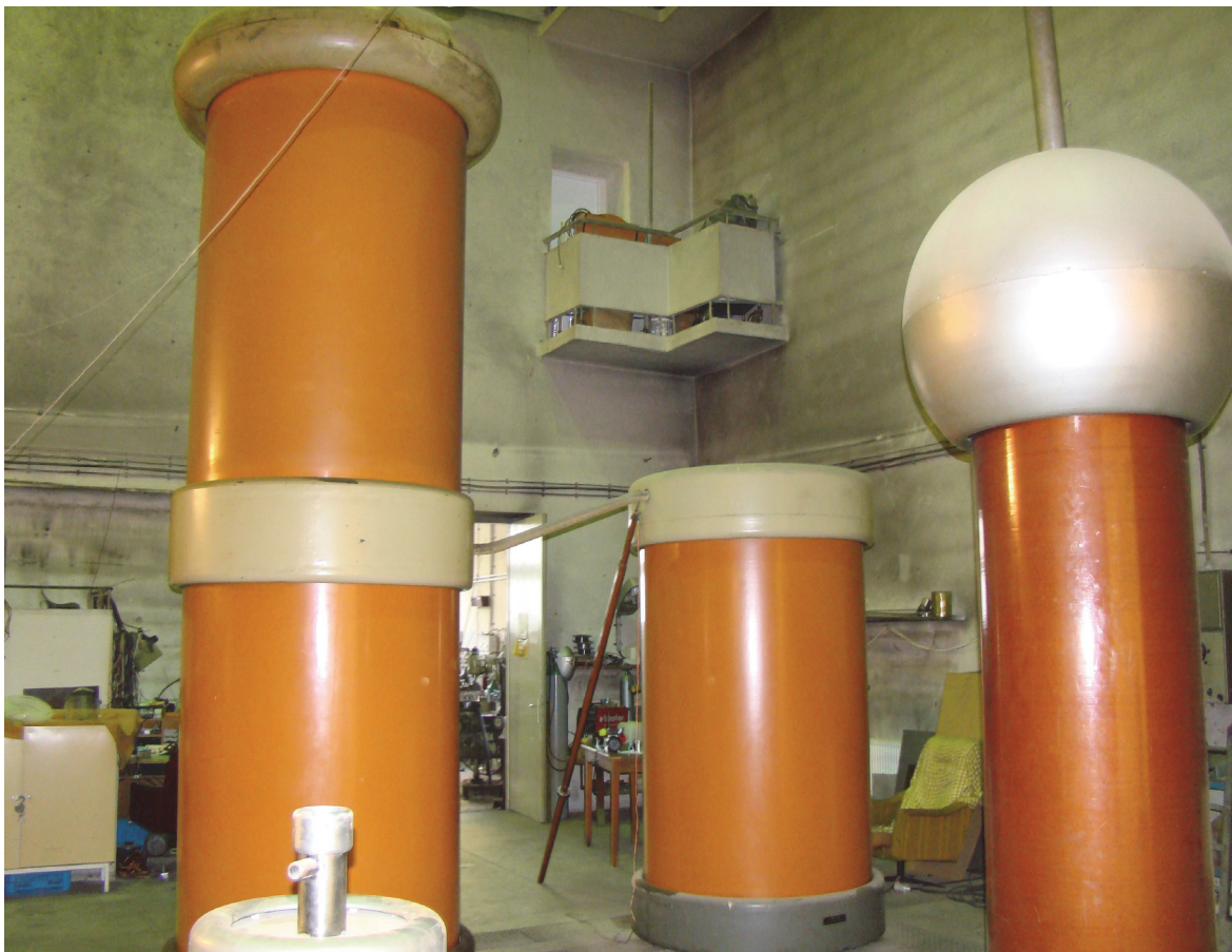
Rys. 13. Kaskada transformatorów probierczych 2x300 kV w hali wysokich napięć laboratorium wysokonapięciowego Politechniki Łódzkiej, zbudowanego pod kierownictwem prof. Zygmunta Hastermana
