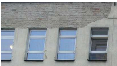
Fot. 2. Elewacja budynku z oderwanym fragmentem zdegradowanego tynku podczas działania silnego wiatru
