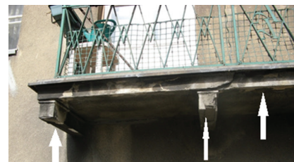
Fot. 4. Uszkodzenia tynków balkonów
