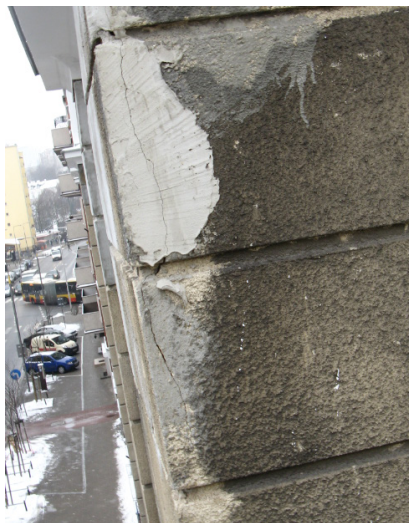
Fot. 8. Odpadające uzupełnienia ubytków tynków
