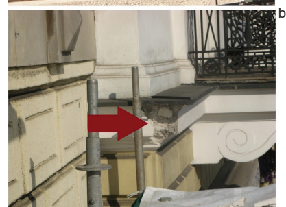
Fot. 6. Uszkodzenia tynków na gzymsach: a) objawy uszkodzenia; b) zachowanie się tynku po uderzeniu młotkiem
