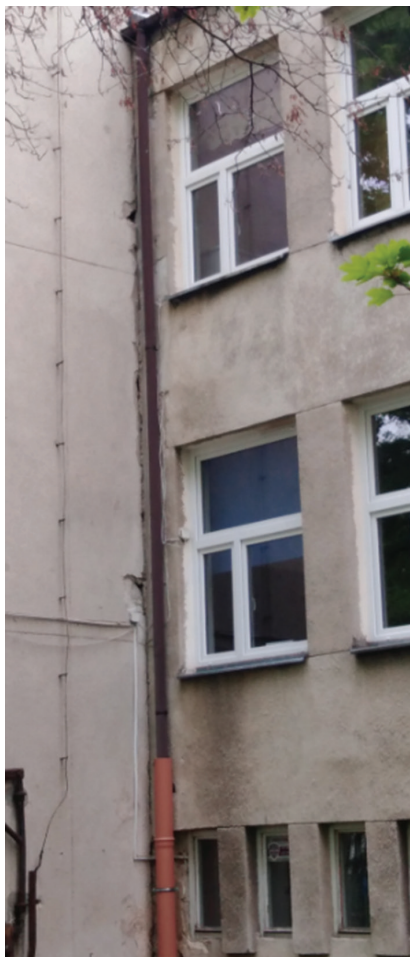
Fot. 7. Degradacja tynków w pobliżu uszkodzonej rury spustowej
