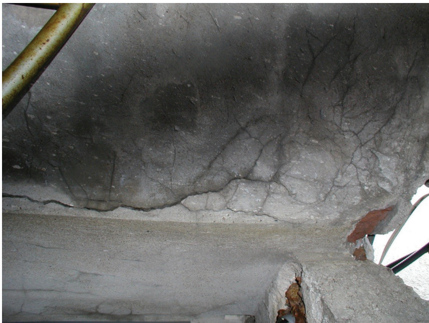
Fot. 1. Degradacja tynku cementowo-wapiennego z długo niezabezpieczanymi spękaniem skurczowymi
