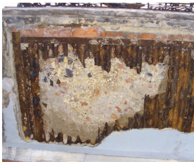
Rys. 4. Widok balkonu od spodu, widok resztek skorodowanej, stalowej płyty falistej, brak spodniej warstwy tynku
