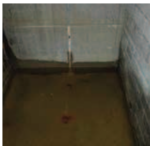
Rys. 10. Nieszczelność ścian szybów windowych na styku z płytą fundamentową
