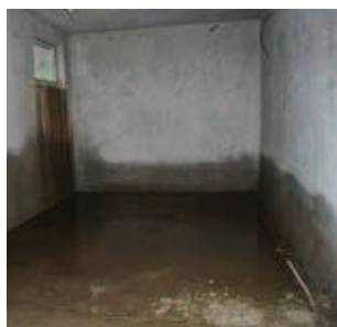
Rys. 11. Nieszczelność na styku ścian żelbetonowych piwnicy z płytą fundamentową, woda spiętrzyła się powyżej posadzki piwnicy
