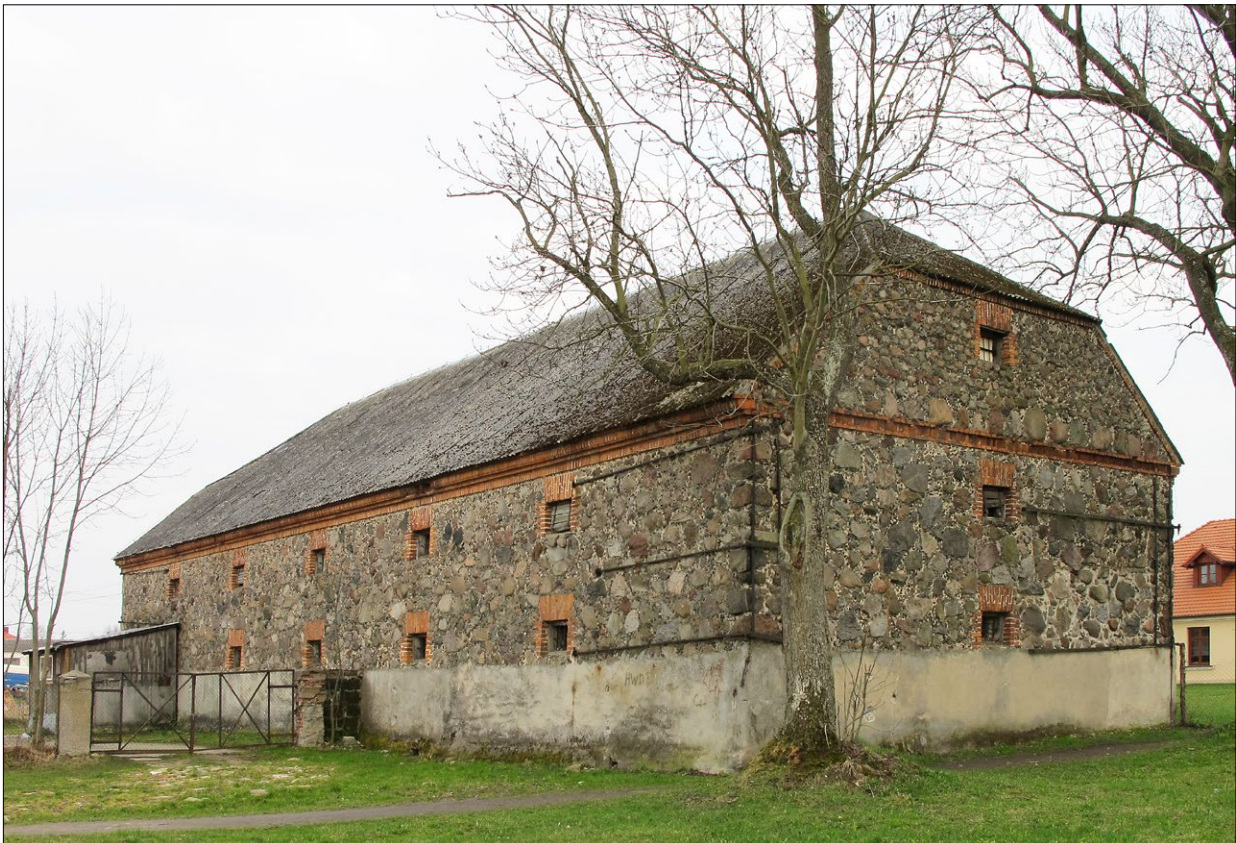
Ryc. 7. Rościszewo – kamienny spichlerz dworski. W spoinach znajdują się grudki rudy darniowej, rok 2010; fot. R. Piotrowski. Fig. 7. Rościszewo—stone manor granary. Fragments of bog ore can be seen in the joints, 2010; photo by R. Piotrowski.
