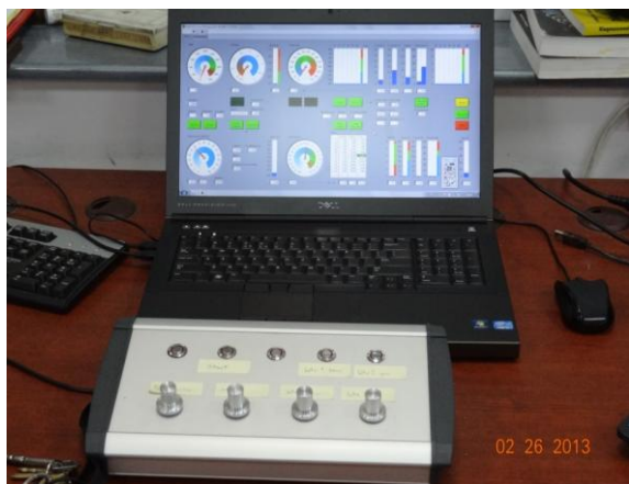
Rys. 3. Widok ogólny panelu sterowania programowalnego sterownika silnika MAN
