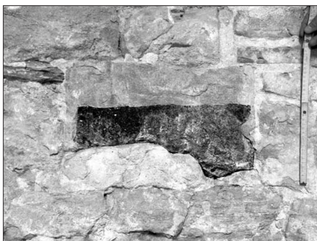
Fig. 5. Ściana kościoła klasztoru Benedyktynów w Tyncu Kształt ciemniejszego kamienia wskazuje na jego wtórne użycie
