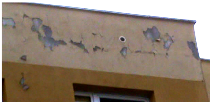
Rys. 1. Złuszczenia wyprawy tynkarskiej
