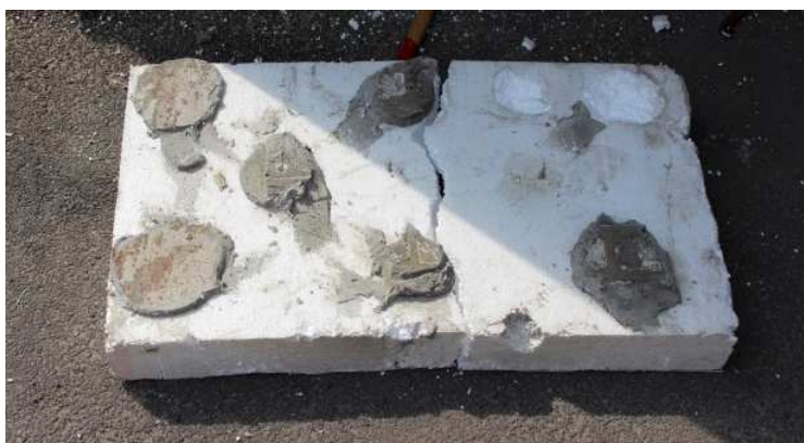
Rys. 4. Wadliwe rozmieszczenie zaprawy klejowej na płycie styropianu
