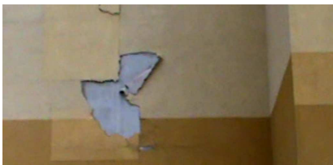
Rys. 2. Odspojenia i powierzchniowe ubytki tynków
