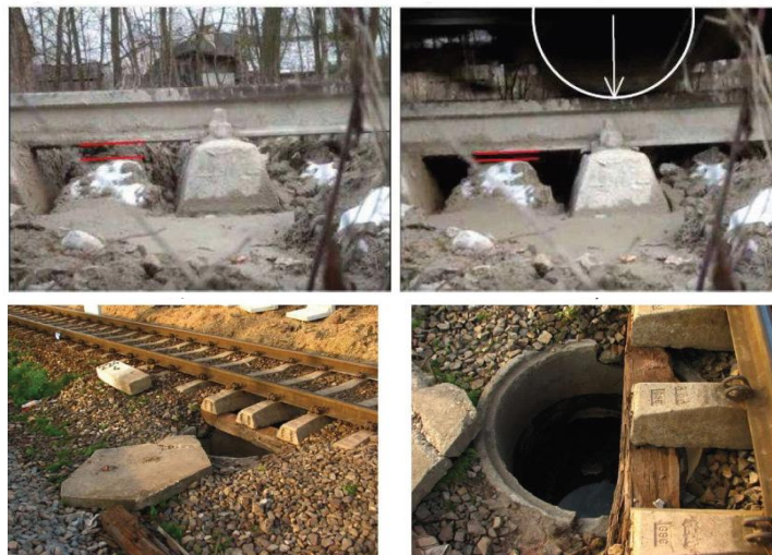
Rys. 1. Ugięcie toru powstałe w czasie eksploatacji oraz podparcie podkładów strunobetonowych za pomocą staroużytecznego podkładu drewnianego [14]
