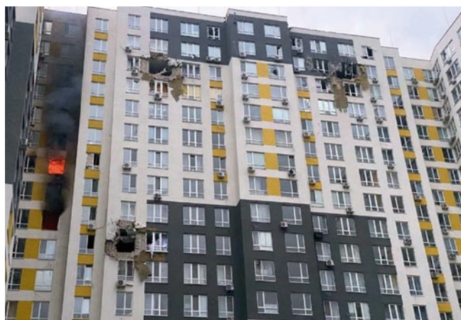
Rys. 1. Częściowo uszkodzony budynek [9]
