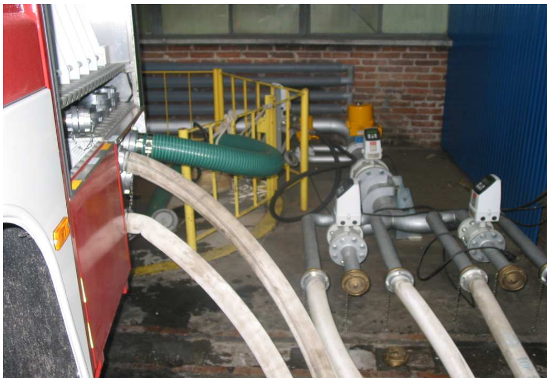
Fot. 8. Widok ogólny stanowiska do badania pomp pożarniczych
