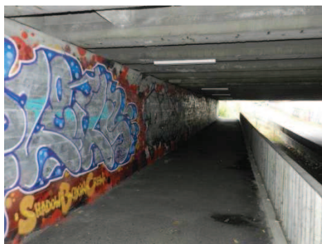
Fot. 19. Przejście przy ul. Przelot – przejście dla pieszych pod wiaduktem w ciągu ul. Dąbrowskiego – niesprawne oświetlenie
