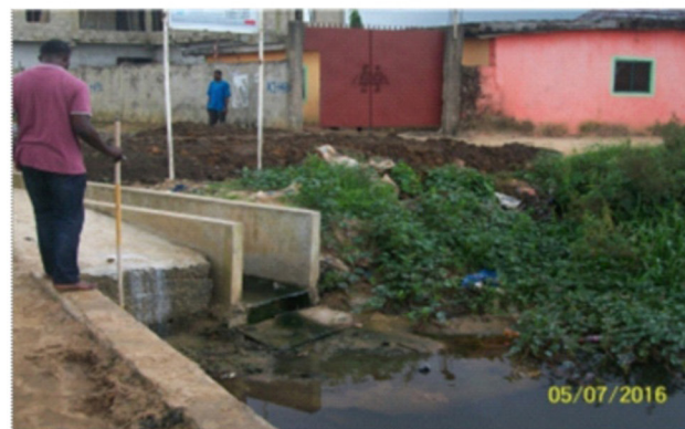
(d) Bank erosion threatening the urban structure
