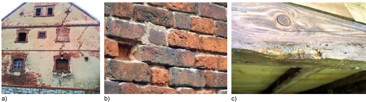
Ryc. 1. Zdegradowane fragmenty konstrukcji: a) muru, b) cegieł i zaprawy, c) drewna Fig. 1. Degraded fragments of structures: a) masonry wall, b) bricks and mortar, c) wood
