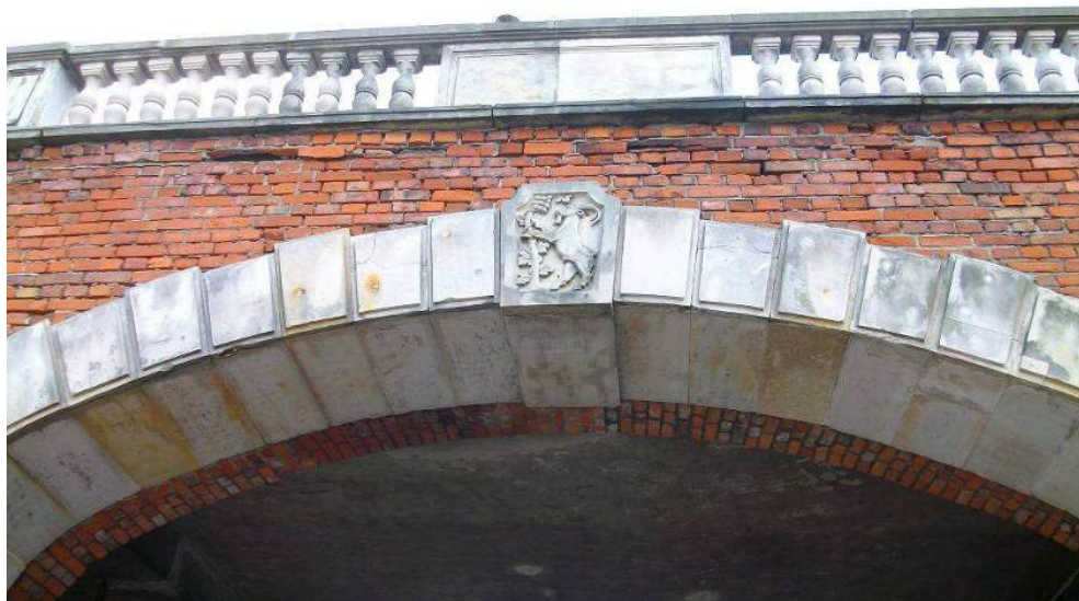
Fot. 12. Pęknięcie muru nad sklepieniem po stronie Placu Zamkowego. Korozja chemiczna i biologiczna płyt kamiennych licowych i sufitowych. Widoczne pęknięcia płyt, przecieki wodne oraz wypadanie cegieł z muru w linii pęknięcia nad sklepieniem [4].
