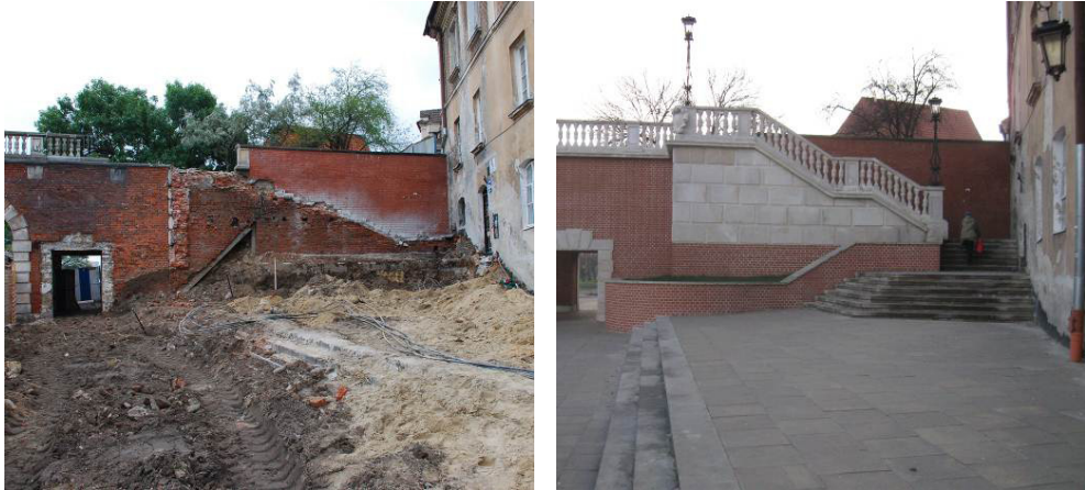
Fot. 20. Schody od strony Placu Zamkowego w trakcie przebudowy i po jej zakończeniu [4 i 5].
