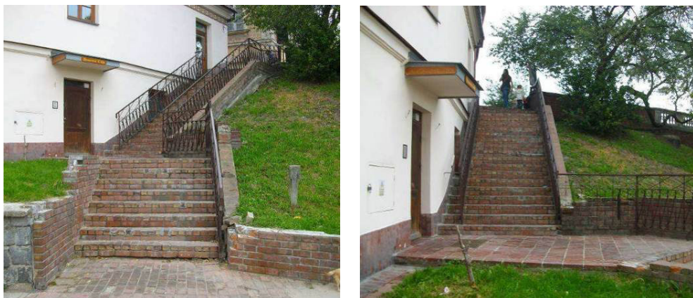
Fot. 16. Nienormowa liczba stopni schodów w ciągu oraz widoczne zniszczenie murku [5].
