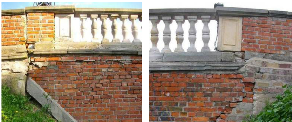
Fot. 11. Uszkodzenia skrzydeł: obruszenia cegieł, odspajanie od muru, osiadanie nasypu; a) widok po stronie Placu Zamkowego, b) widok po stronie Podwala [3].
