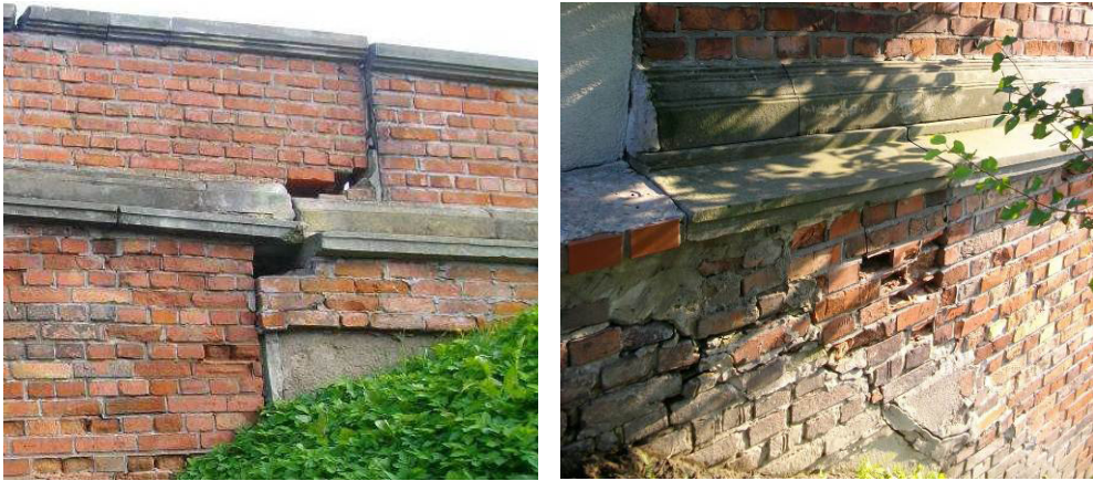
Fot. 10. Osiadanie muru względem skrzydła oraz pęknięcie w miejscu styku ze skrzydłem [4].
