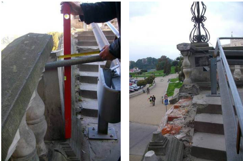
Fot. 15. Odchylenie balustrady schodów od pionu o 5 cm/70 cm. Na zdjęciu widoczne również tymczasowe zabezpieczenie przed wejściem pieszych [4].
