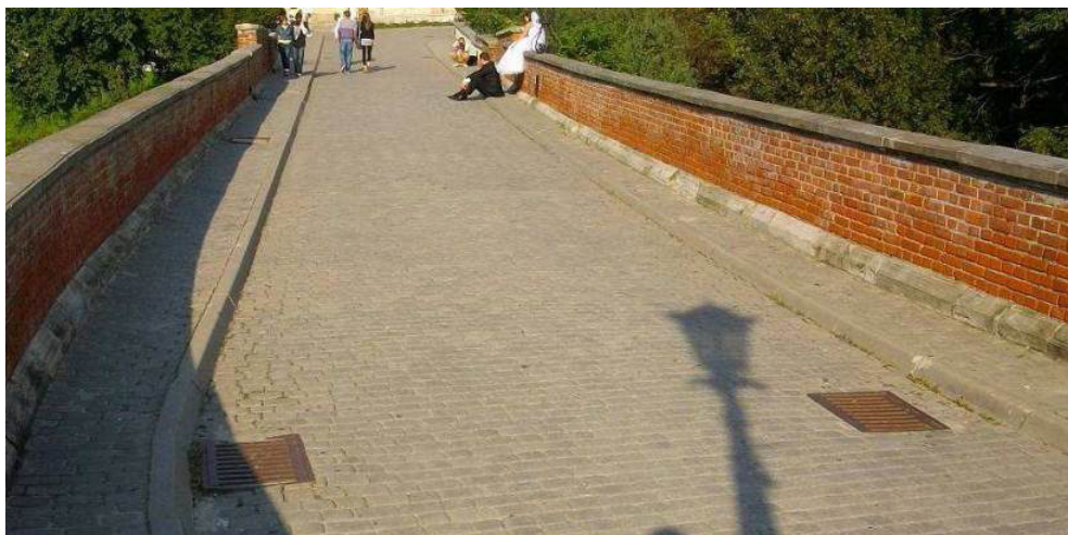
Fot. 8. Nieprawidłowe odległości między wpustami, niezgodne z wymaganiami spadki nawierzchni, deformacje nawierzchni oraz obniżenie nawierzchni względem wpustów [4].
