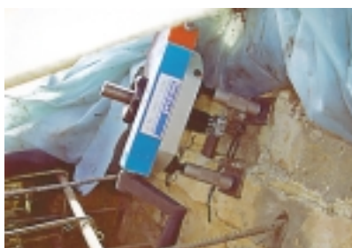
Rys. 27. Badanie wytrzymałości na wrywanie połączenia klejowego strzemion stalowych wklejanych w powłokę ceglana kopuły w celu zespolenia nowo wprowadzanych łąber żelbetowych z ceglana powłoką kopuły
