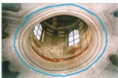
Rys. 6. Kopuła w Owieńskach – spękania obwodowe wokół podstawy latarni [1], [2], [3]
