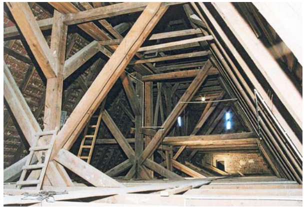
Ryc. 4. Widok konstrukcji dachu nad nawą po przebudowie. W głębi konstrukcja nad pierwotną częścią nawy, z przodu dwa wiązory pełne w dobudowanej części nawy Fig. 4. View of roof structure after reconstruction. In the background structure over the original nave fragment, at front – two full trusses in the extension fragment
