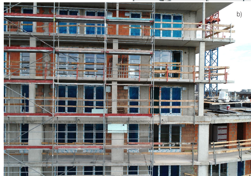
Rys. 4. Widok na brakujące elementy konstrukcji rusztowania (belki krawężnikowe): a) chmura punktów; b) rzeczywiste zdjęcie na rusztowanie
