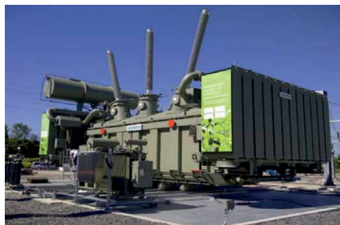
Rys. 1. Pierwszy nowy transformator energetyczny 420 kV napełniony cieczą FR3 i zainstalowany w Niemczech w 2013 r.
