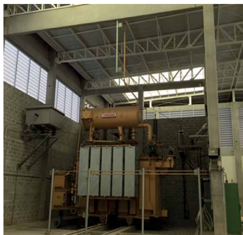
Rys. 2. Zasilanie Olimpiady w Rio de Janeiro w 2016 r. przez transformatory napełnione estrem naturalnym
