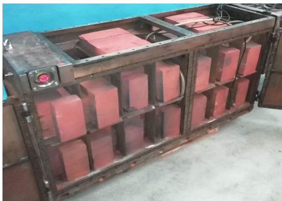
Rys. 7. Widok wypełnienia wnętrza komory skrzyni akumulatorowej [7]
