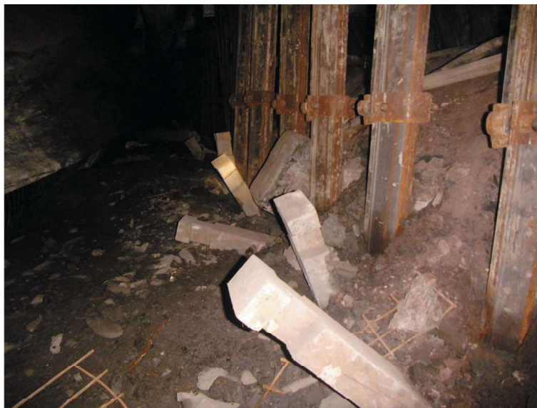
Rys. 13. Połamane podkłady pod stojakami i wypiętrzony spąg (metraż 510 m)
