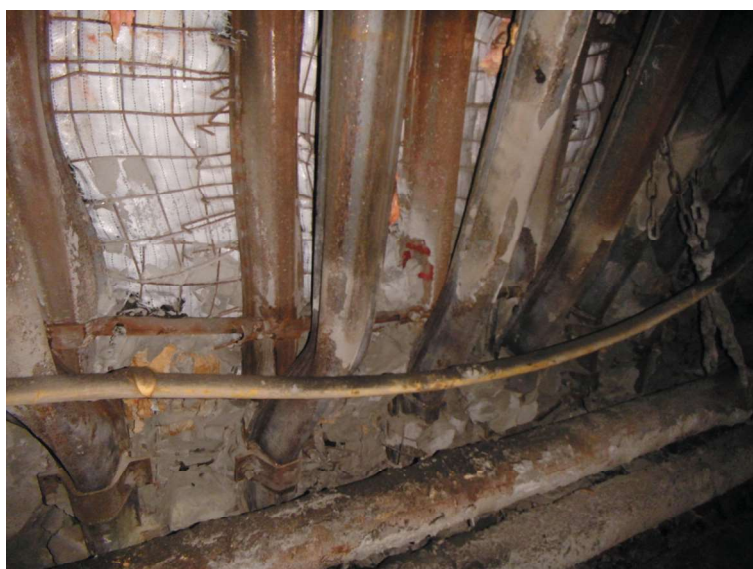
Rys. 14. Lokalna utrata stateczności odrzwi i elementów wzmacniających (metraż 335)
