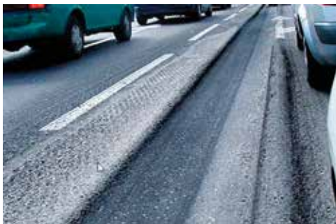
Fot. 2. Niebezpieczne koleiny (Źródło http://www.wczestochowie.pl/kategoria/komunikacja/11296,niebezpiecznie-w-rejonie-estakady-koleiny-jak-rowy )
