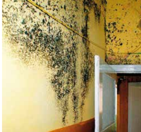
Fot. 3. Wilgoć w domu na ścianie (Źródło: http://murator-dom.pl/galeria/zdjecie-wilgoc-w-domu-wilgoc-na-scianie,18_9114_28917.html )
