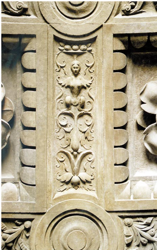
Fragment kopuły po konserwacji. Widoczny całkowicie zrekonstruowany ornament groteskowy w masie sztucznego kamienia
