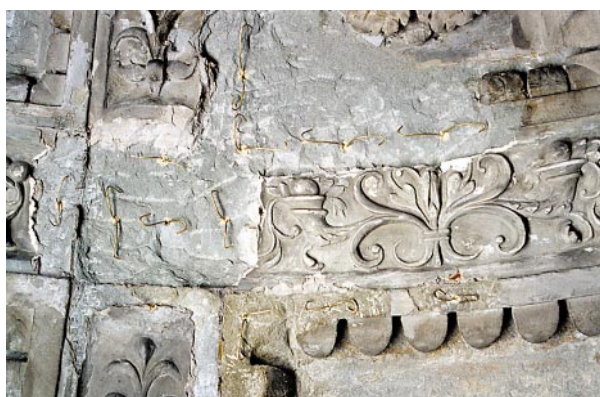
Zniszczony fragment kasetonów kopuły. Zbrojenie z drutów mosiężnych pod planowaną rekonstrukcję z masy sztucznego kamienia
