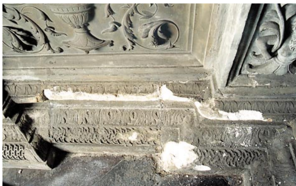
Zniszczony fragment cokołu. Widoczne późniejsze uzupełnienia gipsowe
