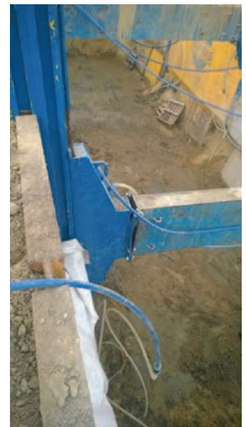
Rys. 5. Uszkodzone połączenie kołnierzowe rozporę
