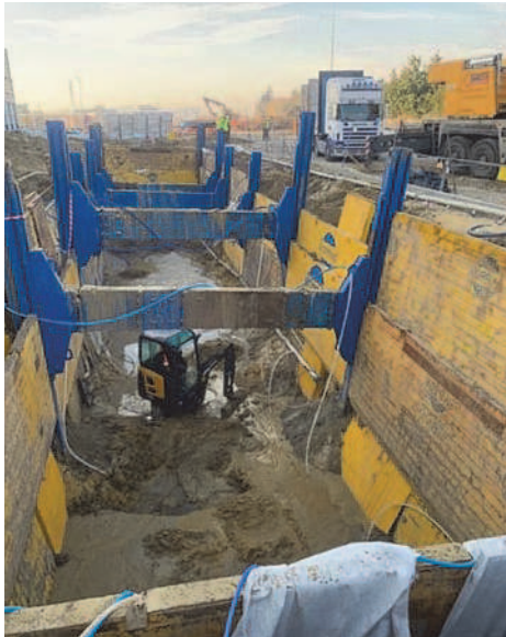
Rys. 6. Miejsce, w którym grunt zza obudowy (piasek drobny) wpłynął do wykopu
