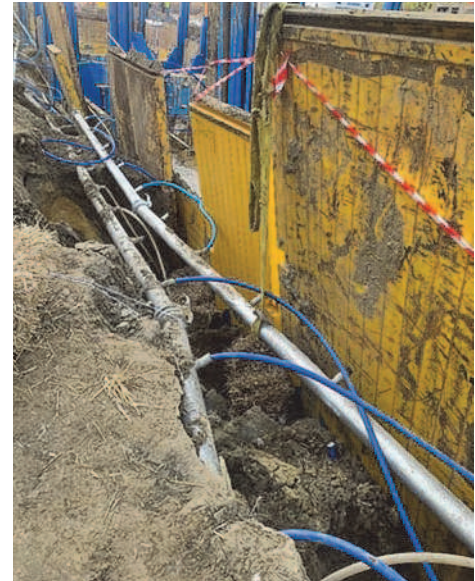
Rys. 7. Oberwany grunt za obudową wykopu
