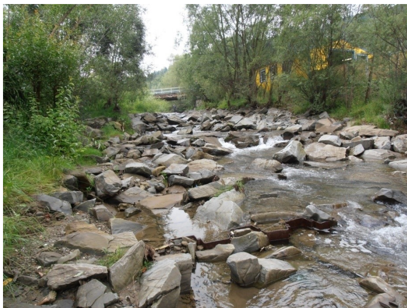
Rys. 1. Bystrze o zwiększonej szorstkości na potoku Poniczanka Fig. 1. Block ramp on the Poniczanka Stream
