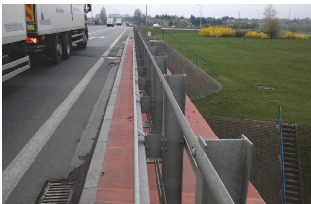
Rys. 8. Brak chodników na wiadukcie
