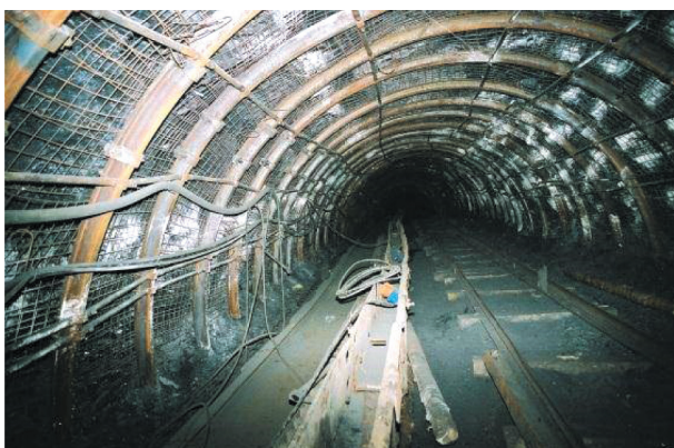
Rys. 6. Rozcinka wykonana w odrzwiach kojarzonych ŁPK ze skróconymi łukami ociosowymi
