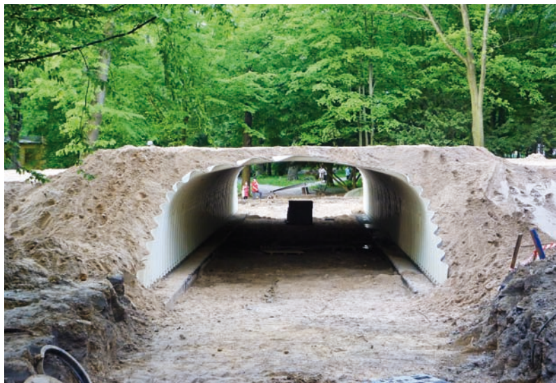
Ryc. 7. Widok konstrukcji gruntowo-powłokowej przepustu w trakcie wykonywania zasyпки w pachwinach i górnej części ścian. Widoczne równomierne (symetryczne) rozłożenie poszczególnych warstw zasyпки po obu stronach konstrukcji osłonowej
