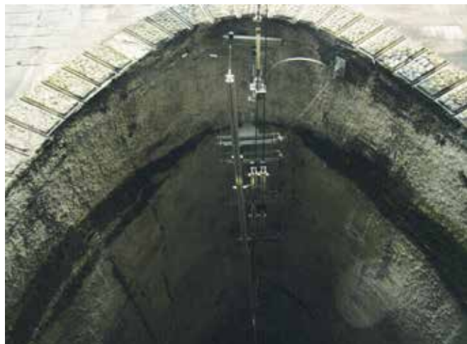
Fot. 1. Wlot do tunelu na linii kolejowej Kozłów-Tunel (strefa przejściowa: sieć łańcuchowa-sieć sztywna). Fot. W. Majewski
