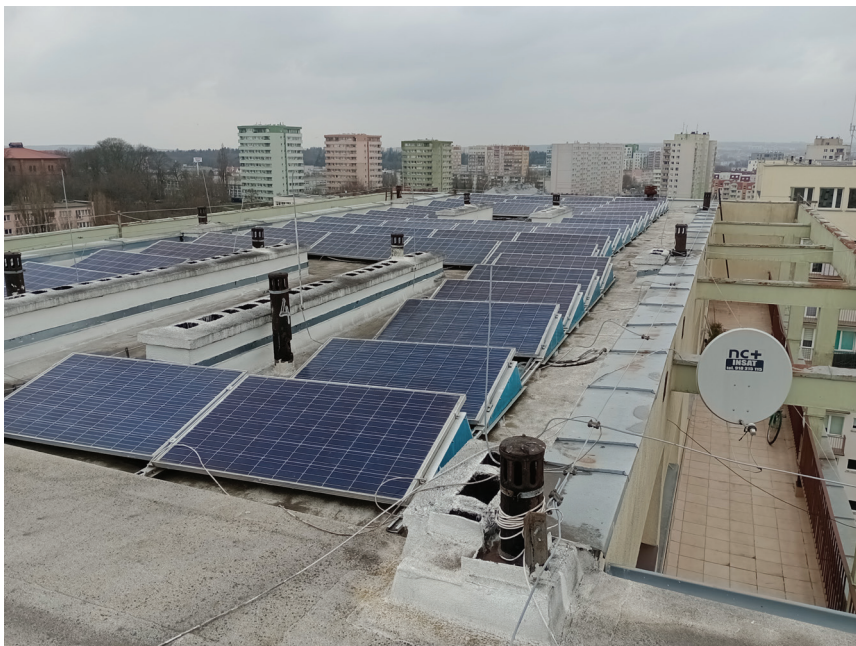
Fot. 1. Panele słoneczne zainstalowane na jednym w technologii „systemu szczecińskiego”
