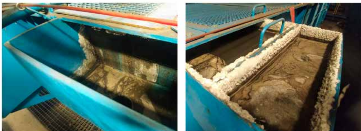
Rys. 4. Ślady trybokorozji na ścianach wanny odżuźlacza widoczne w czasie pracy w warunkach wysokiej temperatury wody w wannie
