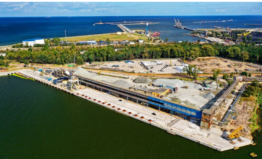
Modernizacja nabrzeża Obrońców Poczty Polskiej w Porcie Gdańsk, fot. Port Gdańsk SA
