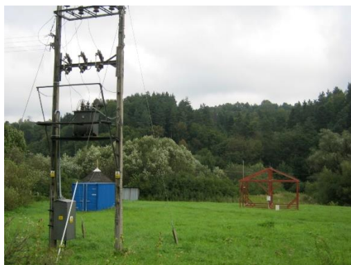
Rys. 3. Słupowa stacja transformatorowo-rozdzielcza z przyłączoną linią napowietrzną
