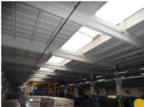
Rys. 1. Przykładowy widok dachu – w części świetlikowej brak nadbetonu połączeniowego
