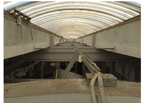
Rys. 2. Przykładowy widok dachu w obrębie świetlika łukowego – brak nadbetonu połączeniowego
