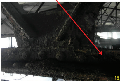
Rys. 7. Korozja pasa dolnego
