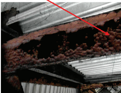
Rys. 6. Korozja pasa górnego
