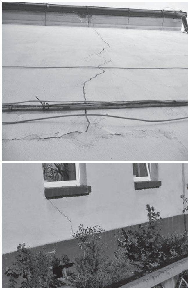
Rys. 9. Pęknięcia na ścianie zewnętrznej zachodniej i wschodniej
