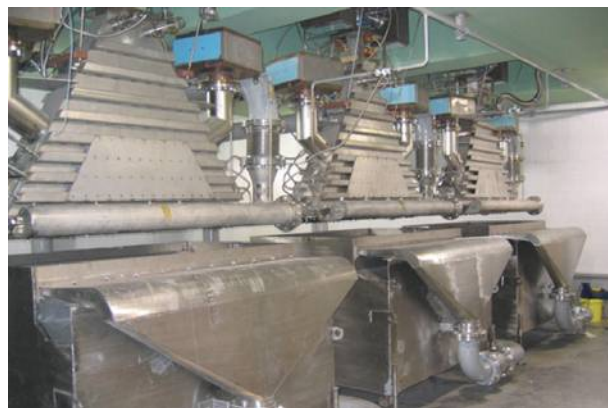
Fot. 3. Widok urządzeń wyjściowych akceleratora ELV 12 pracującego w instalacji do oczyszczania ścieków przemysłowych
