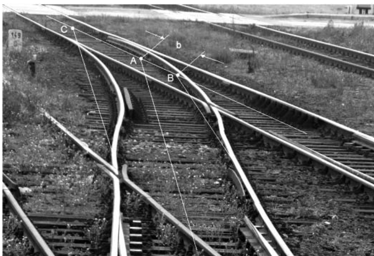
Rys. 7. Niezasadniona wymiana rozjazdu 190-1:9 na rozjazd 300-1:9 (fot. D. Sikorski)
