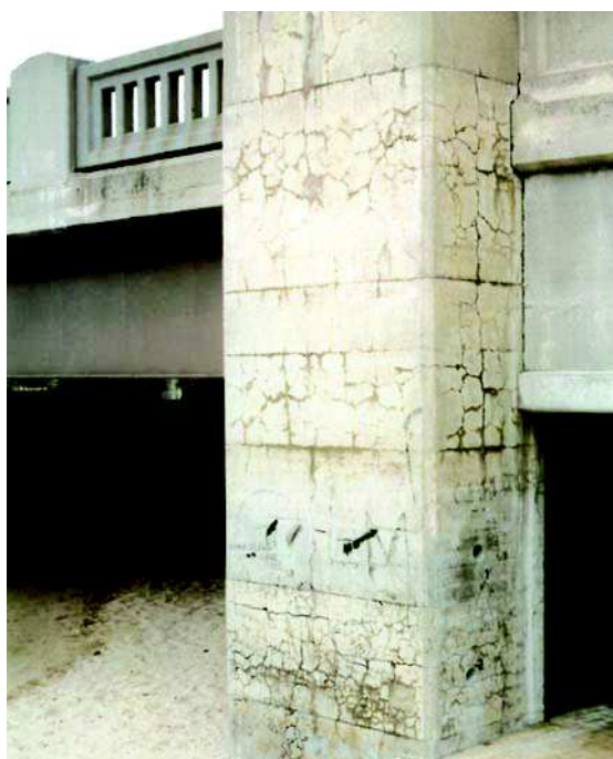
Fot. 8. Spękania siatkowe powstałe wskutek reakcji ASR w filarze mostowym [7]
