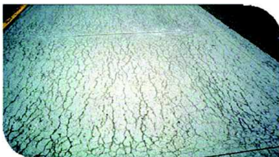
Fot. 3. Spękania podłużne wywołane przez reakcję ASR w nawierzchni betonowej [2]
