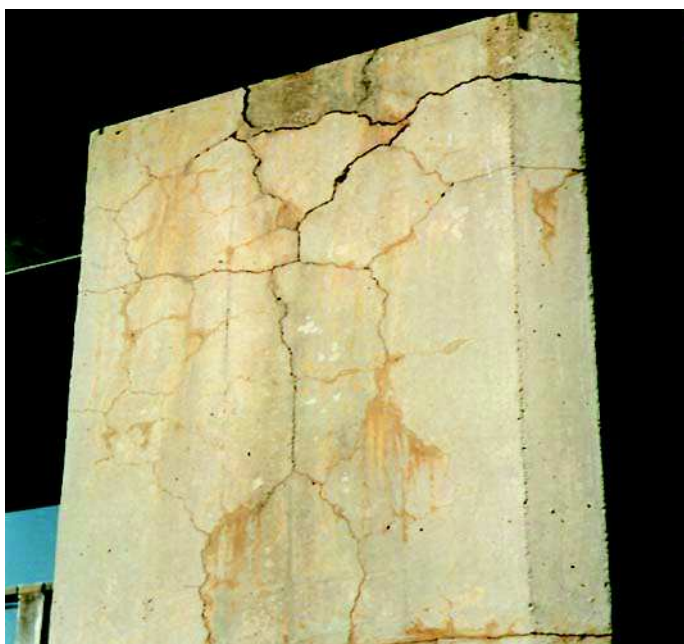
Fot. 7. Typowe spękania siatkowe wywołane reakcją ASR, występujące w podporach dwóch nieeksploatowanych wiaduktów kolejowych w Australii. W betonie do ich budowy zastosowano żwiry rzeczne, zawierające krzemionkę [7]
