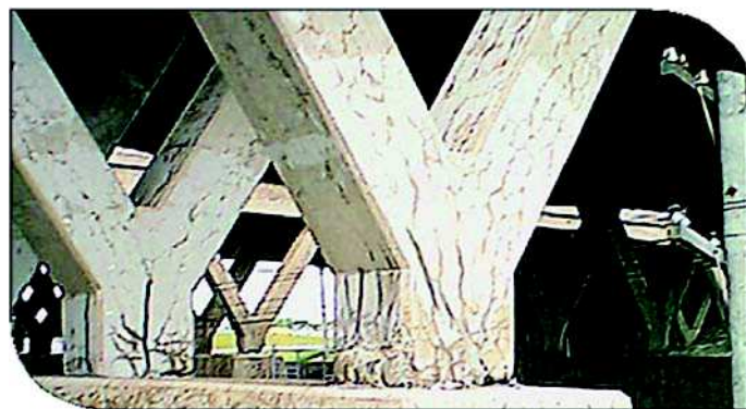
Fot. 9. Spękania powiązane są z kierunkami naprężeń. Przeważające spękania w tej podporze są zorientowane podłużnie [2]
