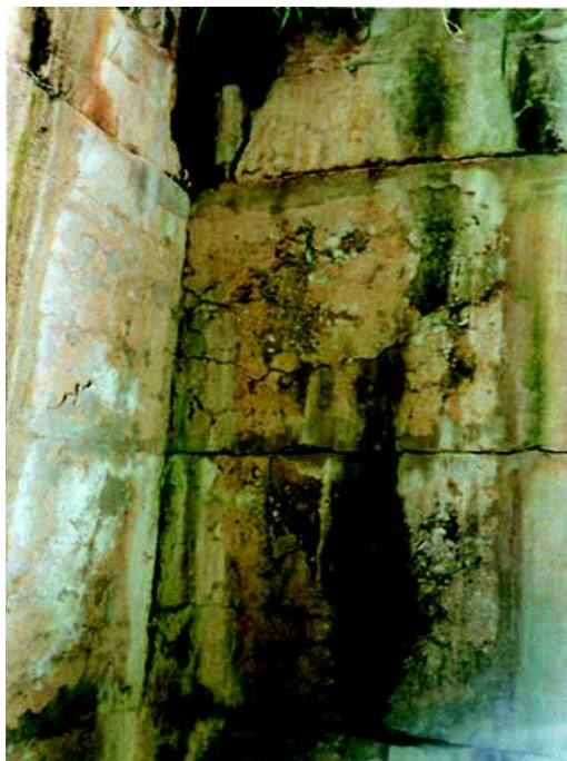
Fot. 10. Naloty powierzchniowe (wykwity) spowodowane wyciekaniem ze spękań i gromadzeniem się żelu ASR na powierzchni ściany oporowej tamy [7]
