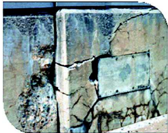
Fot. 1. Ściana bariery betonowej poddana działaniu intensywnej reakcji ASR. Widoczne są spękania, złuszczenia powierzchni betonowych oraz wyształcone podłużne przesunięcia ścian [7]
