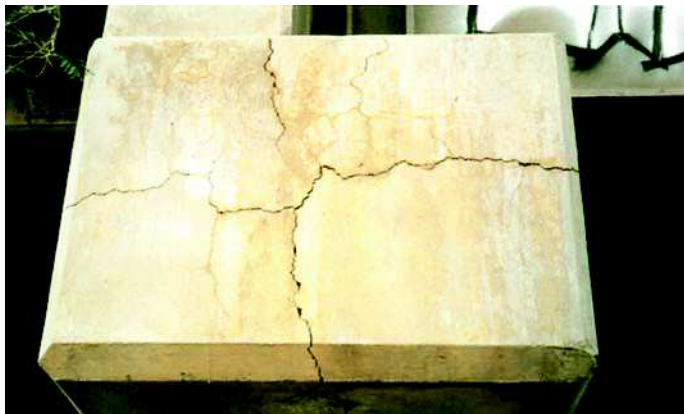
Fot. 12. Zmiana barwy wzdłuż spękań na powierzchni belki mostowej w wyniku postępującej reakcji ASR [7]
