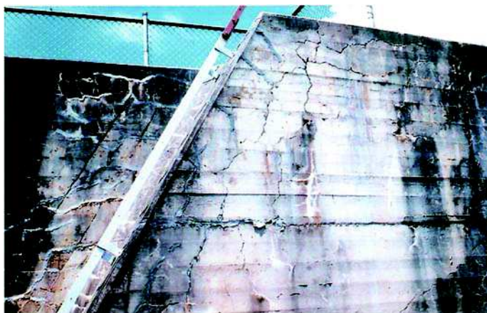
Fot. 2. Przykład zniszczenia konstrukcji z Australii – odkształcona ściana oporowa tamy poddanej działaniu reakcji AAR. W wyniku zaawansowanego procesu destrukcji, w konstrukcji powstały liczne spękania siatkowe, które następnie w ramach naprawy zostały wypełnione żywicami epoksydowymi. Otworzyły się one na nowo, co doprowadziło do wypadania wypełnień starych spękań (widoczne na zdjęciu) i powstania nowych oraz w konsekwencji do odkształceń konstrukcji ściany [7]
