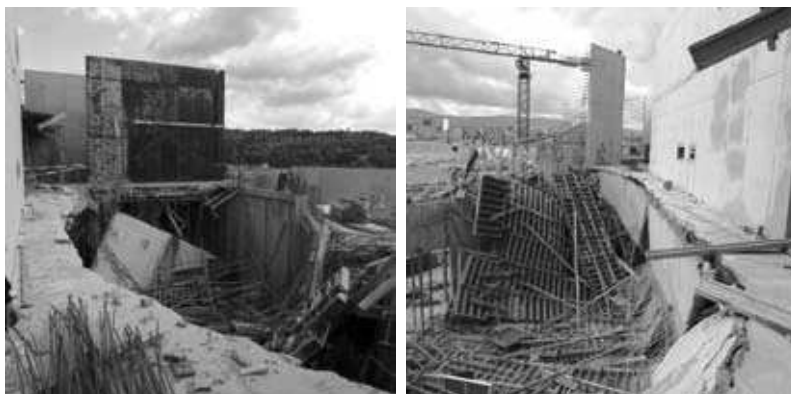
Rys. 5. Kolejne widoki ilustrujące stan konstrukcji po awarii
