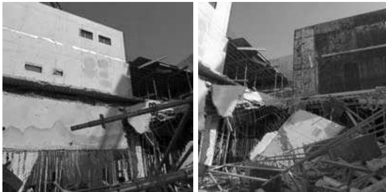
Rys. 4. Widoki zniszczonej konstrukcji
