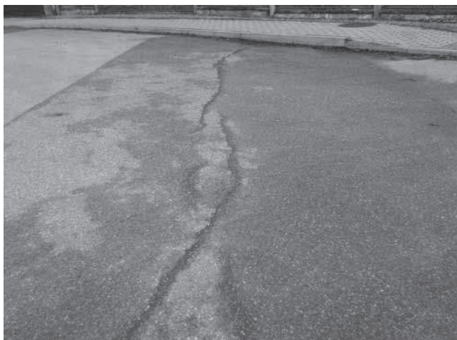
Rys. 9. Liniowa deformacja nieciągła powierzchni w postaci pęknięcia i progu (~10 cm)
