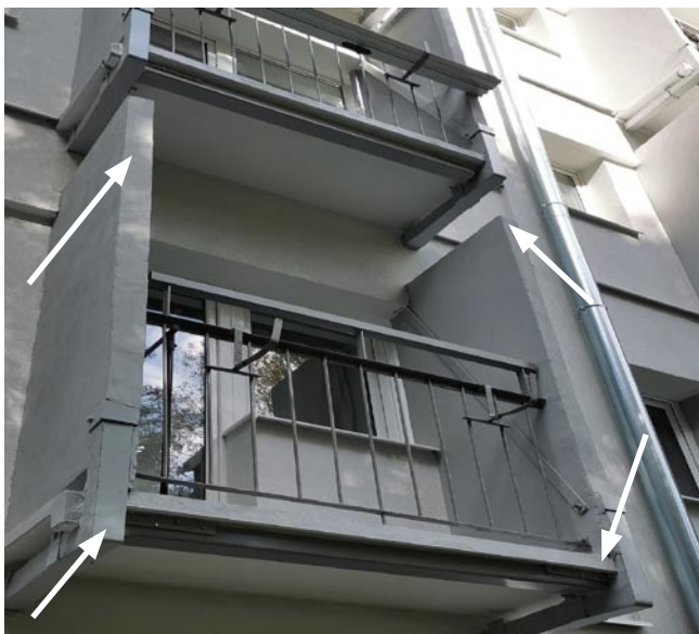
Rys. 5. Po termomodernizacji zmniejszono powierzchnię użytkową balkonów, wymieniono część elementów skorodowanej ramy stalowej, Lublin 2022 r.
