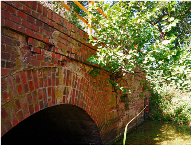
Ryc. 7. Przykład degradacji ściany czołowej ceglano-przewodowego w wyniku intensywnej wegetacji roślinnej na jej powierzchni, fot. A. Wysokowski
