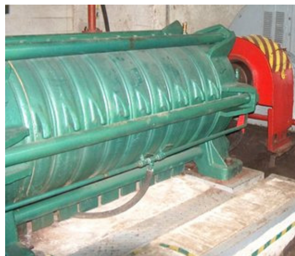
Rys. 2. Widok pompy głównego odwodnienia kopalni
