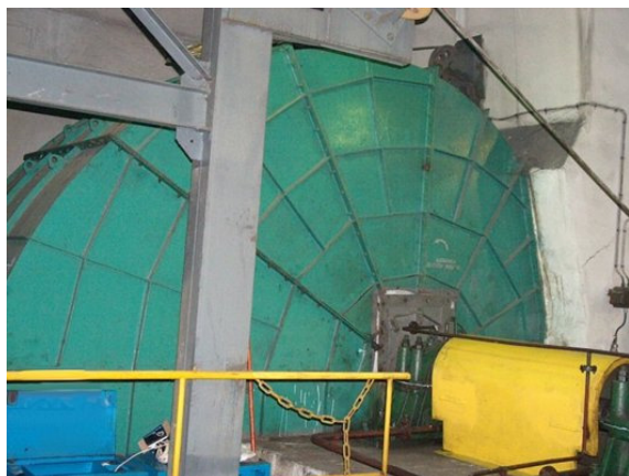
Rys. 3. Widok wentylatora głównego przewietrzania kopalni
