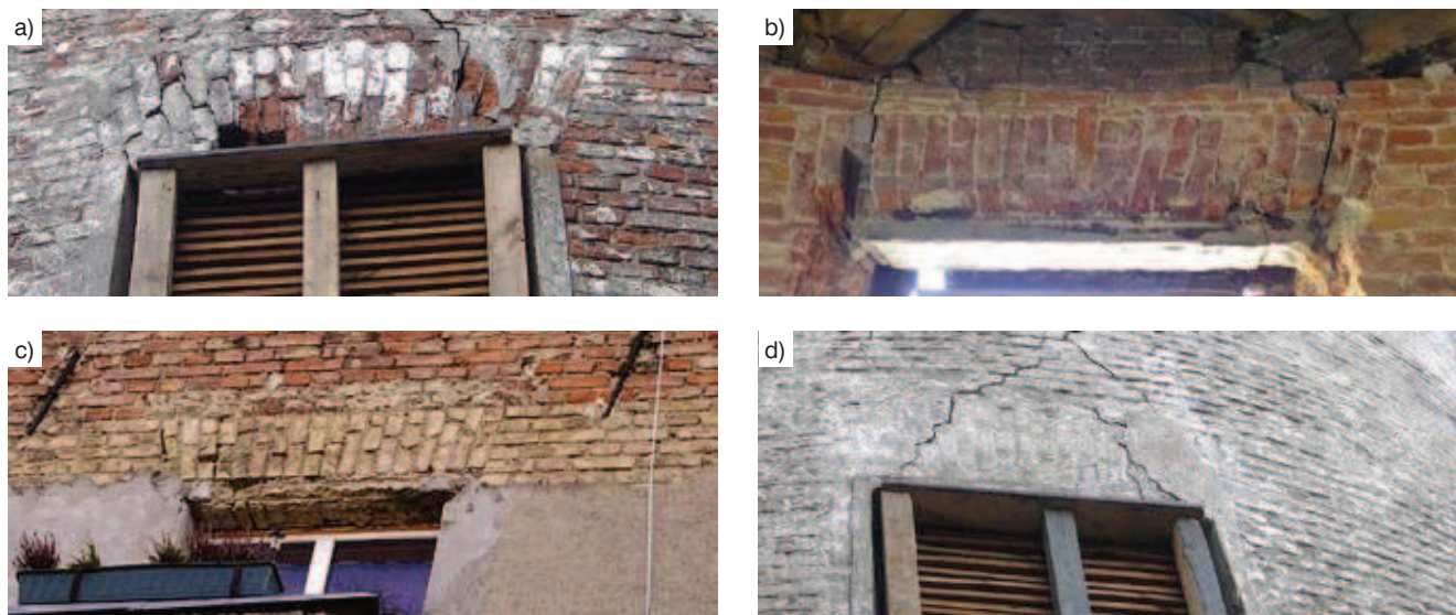
Rys. 1. Przykłady uszkodzenia ceglanych nadproży klinowych
